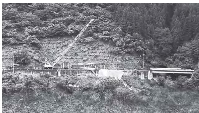
滝沢ダム市道地すべりの現場
